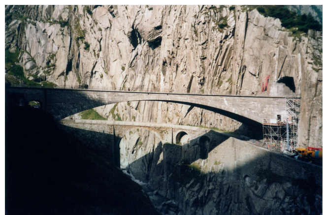
Sanierung Teufelsbrücke im Kanton Uri Renovation of the «Teufelsbrücke» in the Canton Uri
